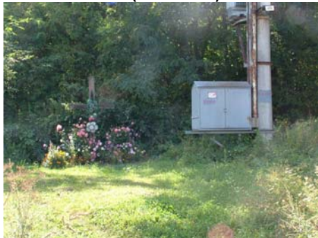
kereszt és trafóoszlop a felhagyott temetőben (hrsz:128)
